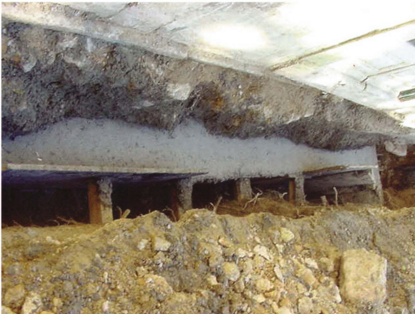
Palácio Pombal. Fases de execução do reforço de fundações da parede da fachada posterior do Palácio com microestacas
