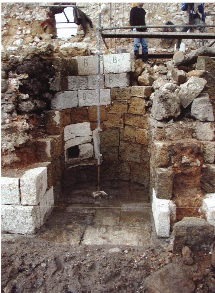
Moinho de Marés do Montijo. Fase de execução de fundações da fachada principal do moinho, com reconstrução do embasamento de pedra
